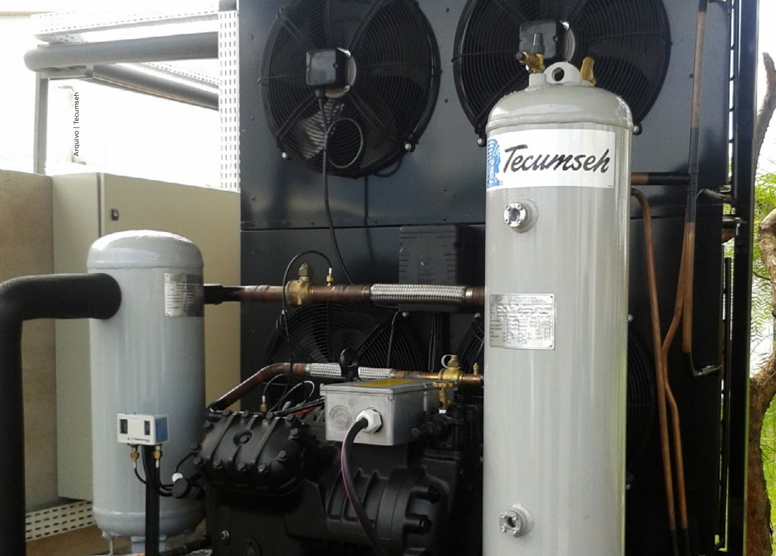
UNIDAD CONDENSADORA con compresor semihermético de 20 HP instalada en industria de Goiânia (GO)
