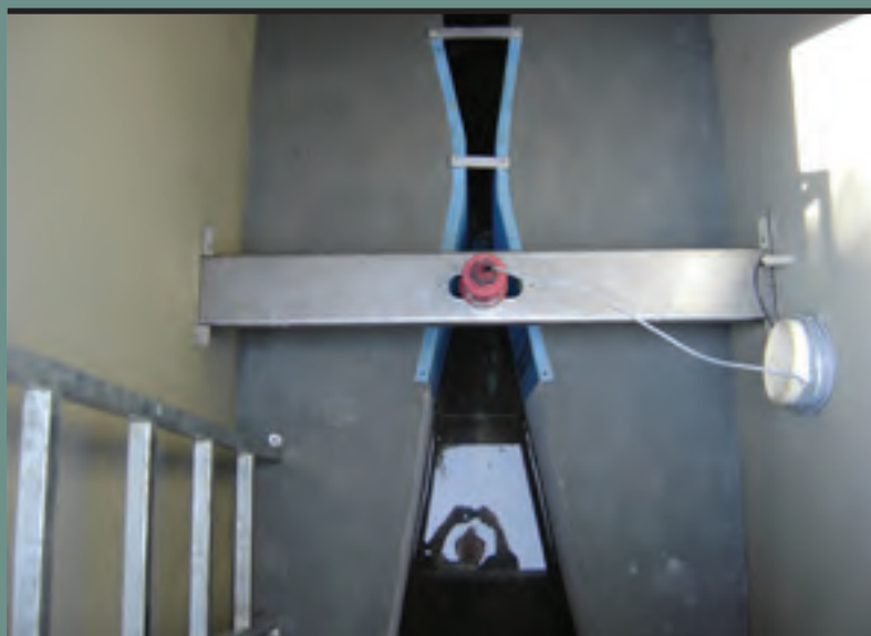
Aforador Parshall instalado en Tecumseh
